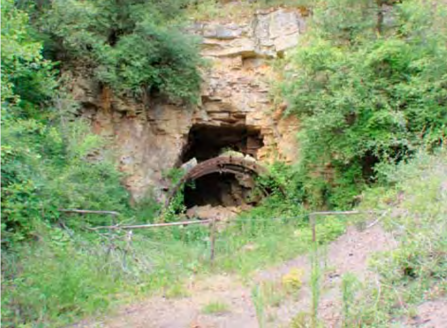
Abb. 53: Verbruchgefährdeter Eingang der Dolomitgrouf Kelsbaach. Foto: Zahlmann.
