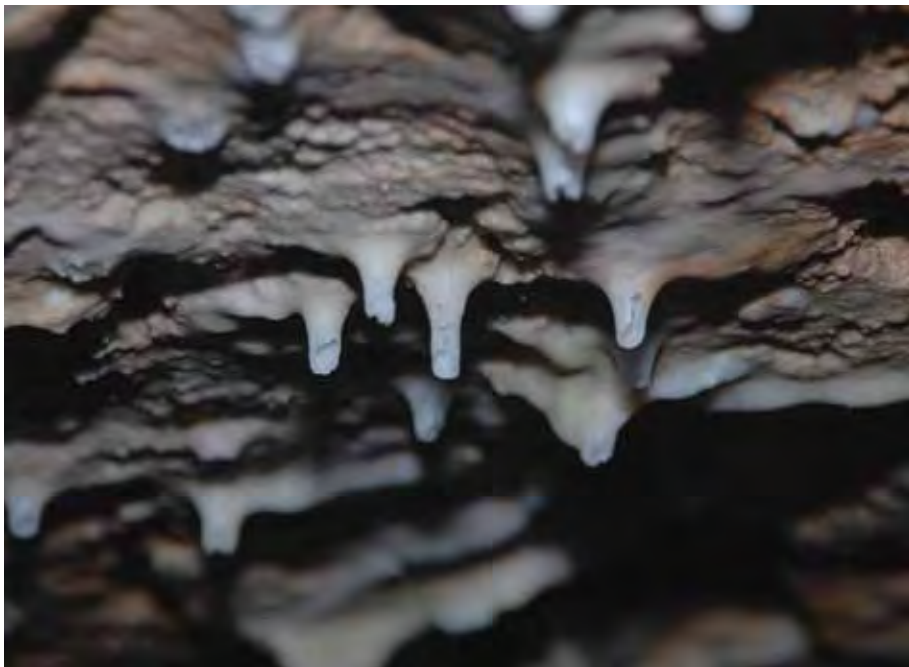
Abb. 58: Im Fort Louvigny haben sich bereits kleine Tropfsteine gebildet, die ihren Kalk von Mörtel beziehen. Foto: Steiner.
