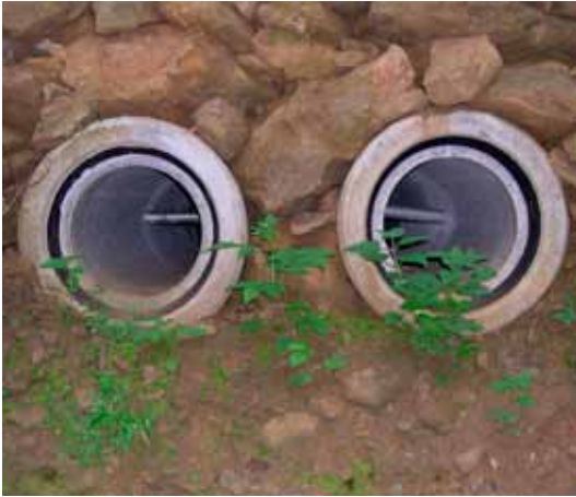
Abb. 8: Ungeeignete Verschlussmaßnahme am Stollen Laangebiert Italien im Jahr 2010.
